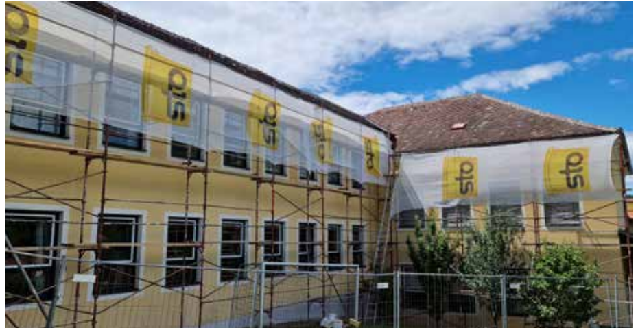
Die Renovierungsarbeiten an der Volksschule schreiten zügig voran und werden bald beendet sein.
